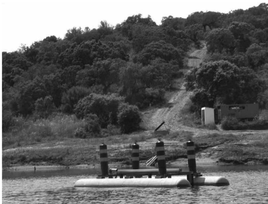
Figura 1 - Captação em jangada com um gerador instalado na margem.
