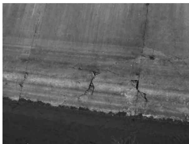
Fotografia 4 - Destacamento de betão na zona das juntas entre painéis.
