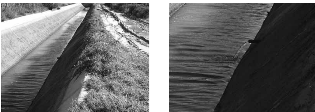
Figura 8 – Canal sujeito a sub-pressões resultantes de má drenagem em canal do AH Campina da Idanha
