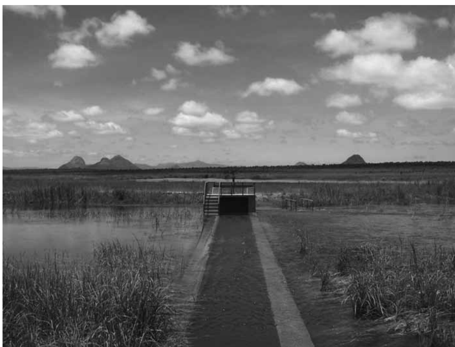
Figura 19 – Estrutura de captação no rio Queve
