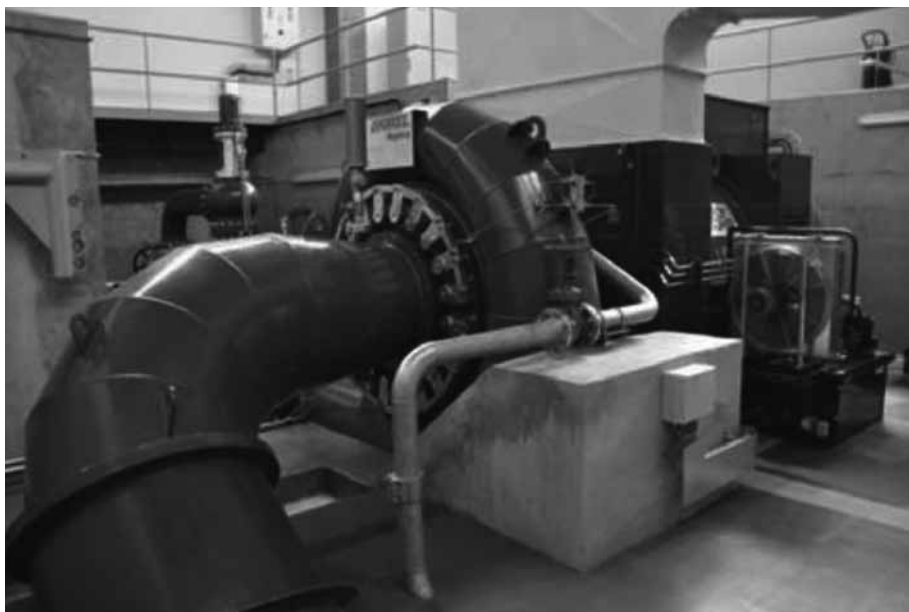
Figura 3 – Turbina e gerador
