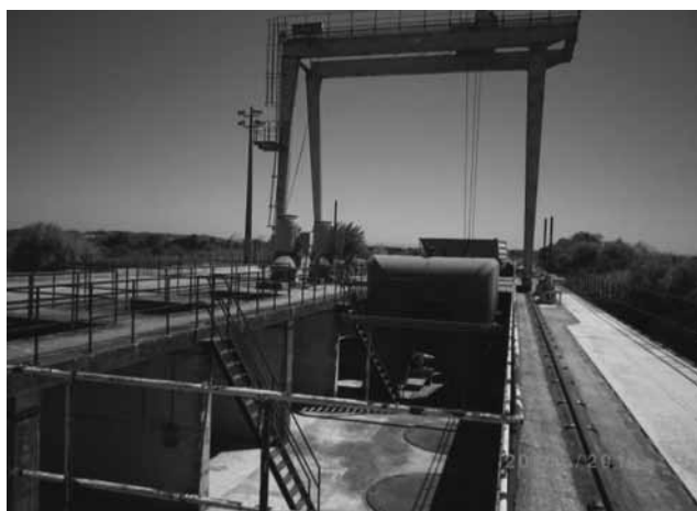
Figura 11 - Estação de Bombagem de Foja.
