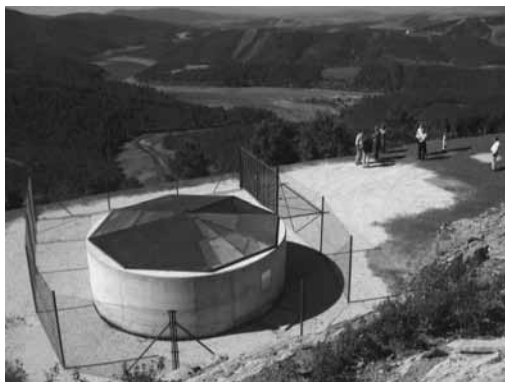
Figura 11 - Circuito Hidráulico Sabugal-Meimoa, chaminé de equilíbrio.
