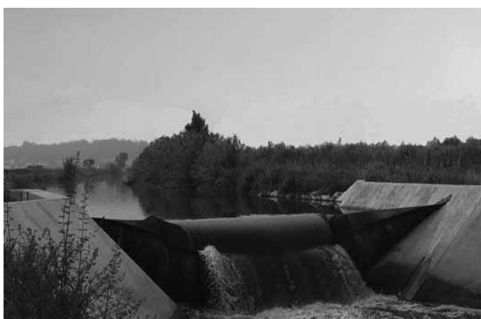
Figura 9 – Açude das Salgadas (após a reabilitação): em plena carga para abastecimento do canal VII
