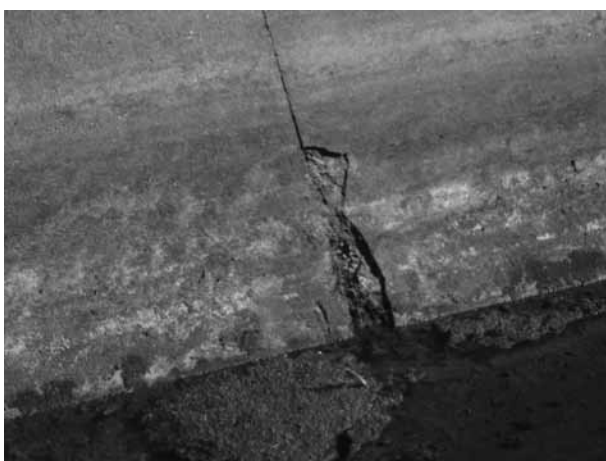
Fotografia 3 - Destacamento de betão junto às fendas.
