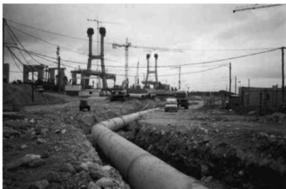
Figura 9 – Conduta de água da Central Térmica do Parque das Nações– DN 900
