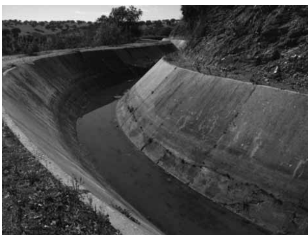
Fotografia 1 - Fissuração longitudinal entre metade e 1/3 da altura das espaldas do canal
