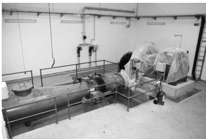
Figura 10 – AH do Pisão. Vista geral do grupo turbina-gerador.
