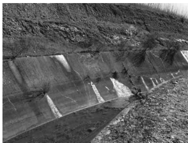
Fotografia 2 - Infiltrações de água e vegetação infestante.
