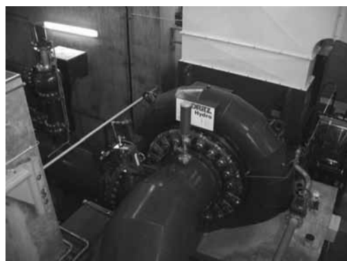
Figura 15 - Central do Meimão, turbina.
