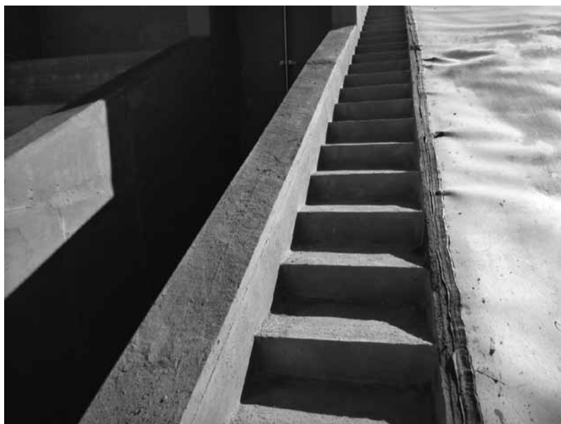
Figura 7 – Pormenor da ligação da tela a um perfil de PEAD/estrutura de betão
