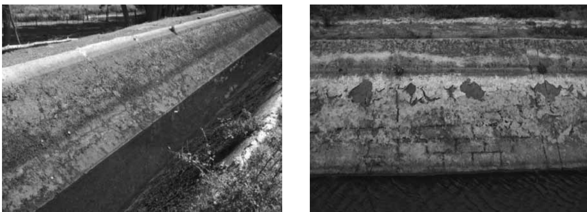
Figura 3 – Canais revestidos com lajetas rosacometta
