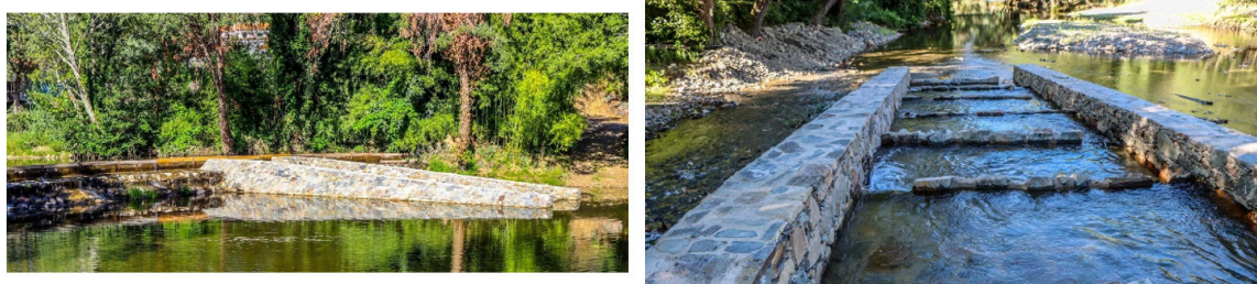
Figura 3. Dispositivo de passagem de peixes no açude de Santo António, na Vila de Góis.
