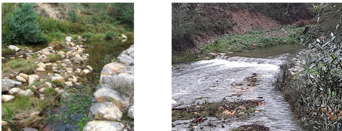
Figura 2. Fotografias do açude da Quinta da Mata, no concelho da Pampilhosa da Serra, antes (à esquerda) e depois (à direita) da obra de reabilitação realizada no âmbito do projeto Rio Ceira.
