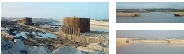
Figura 8.31 - Dique fusível da Barrinha de Esmoriz com pormenores na fase de construção e com a ligação ao mar aberta e encerrada (fonte: ARH Centro).
