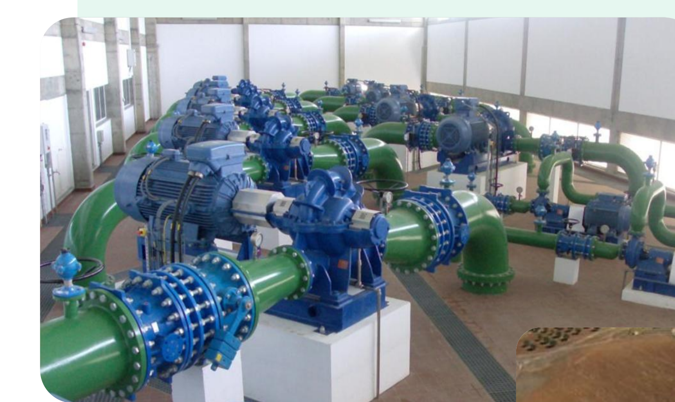
Estação elevatória (Interior)
